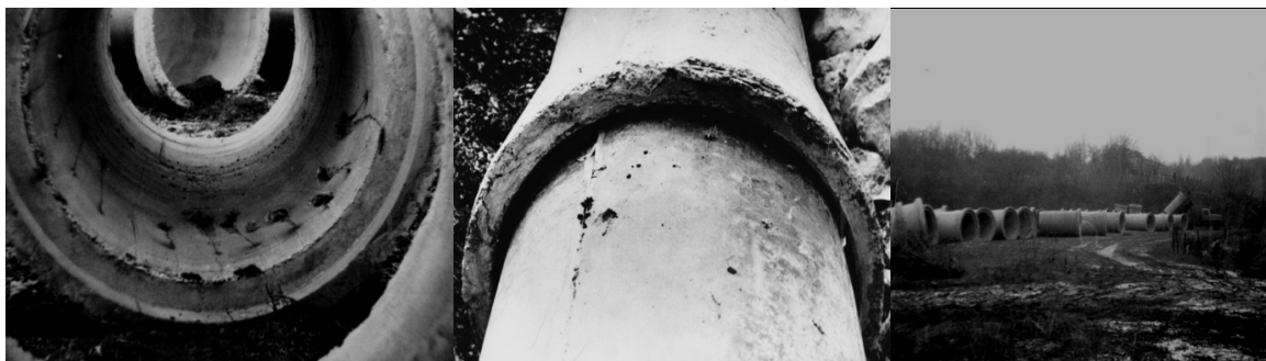
а) заводской брак; б) монтажный брак ; в) монтажные механические повреждения.
