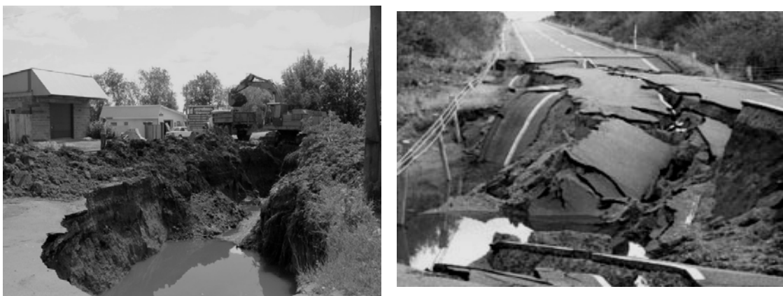
Рисунок 5 - Последствия аварий на канализационных сетях
