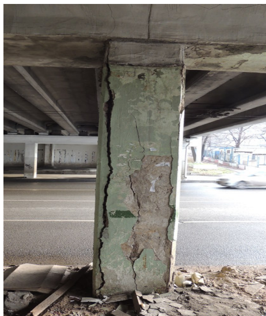
Рисунок 7 Разрушение от пинч-эффекта сжатой бетонной колонны в виде продольных трещин раскола
