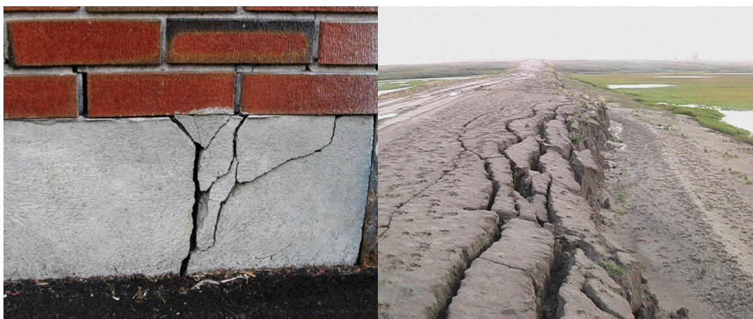
Рисунок 6 Мульды, как причины разрушения зданий и сооружений
