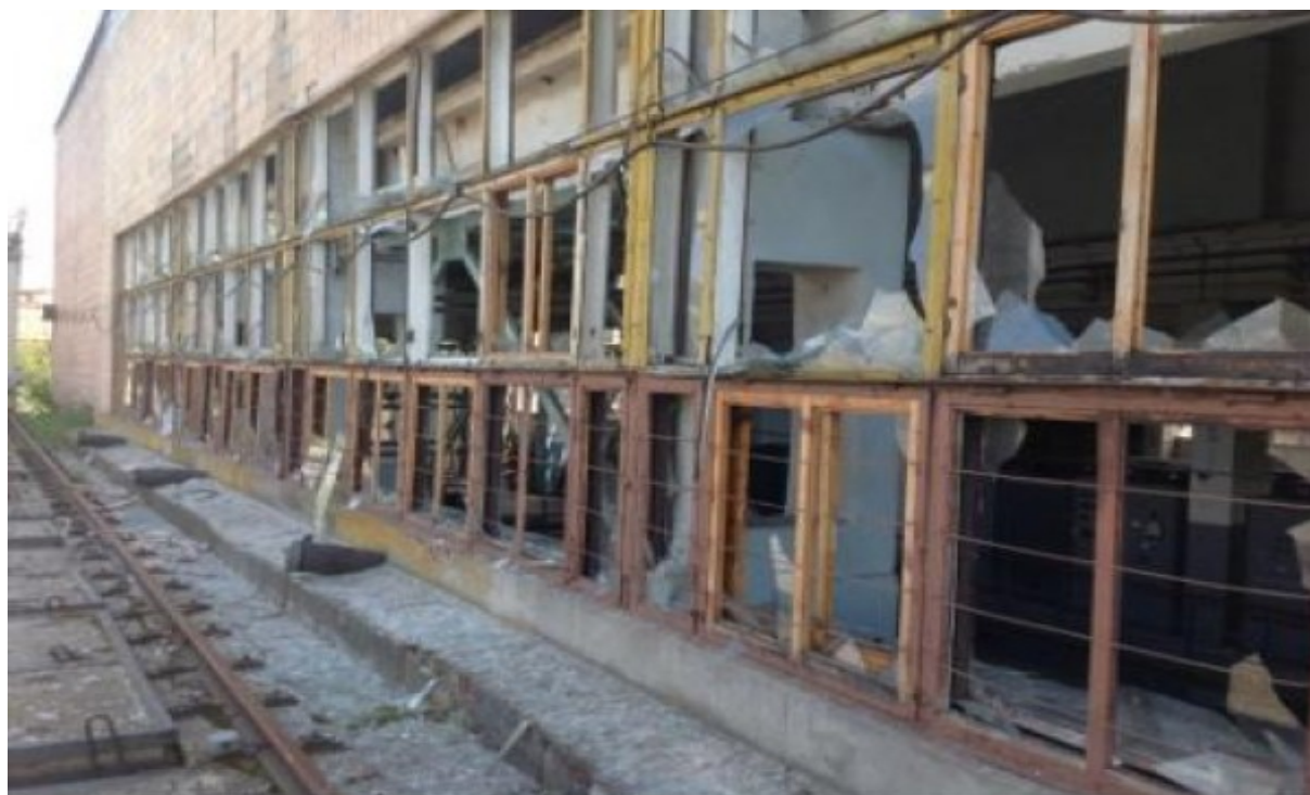
Рисунок 7 Здание насосной станции I-го подъёма Южнодонецкого водопровода после обстрелов
