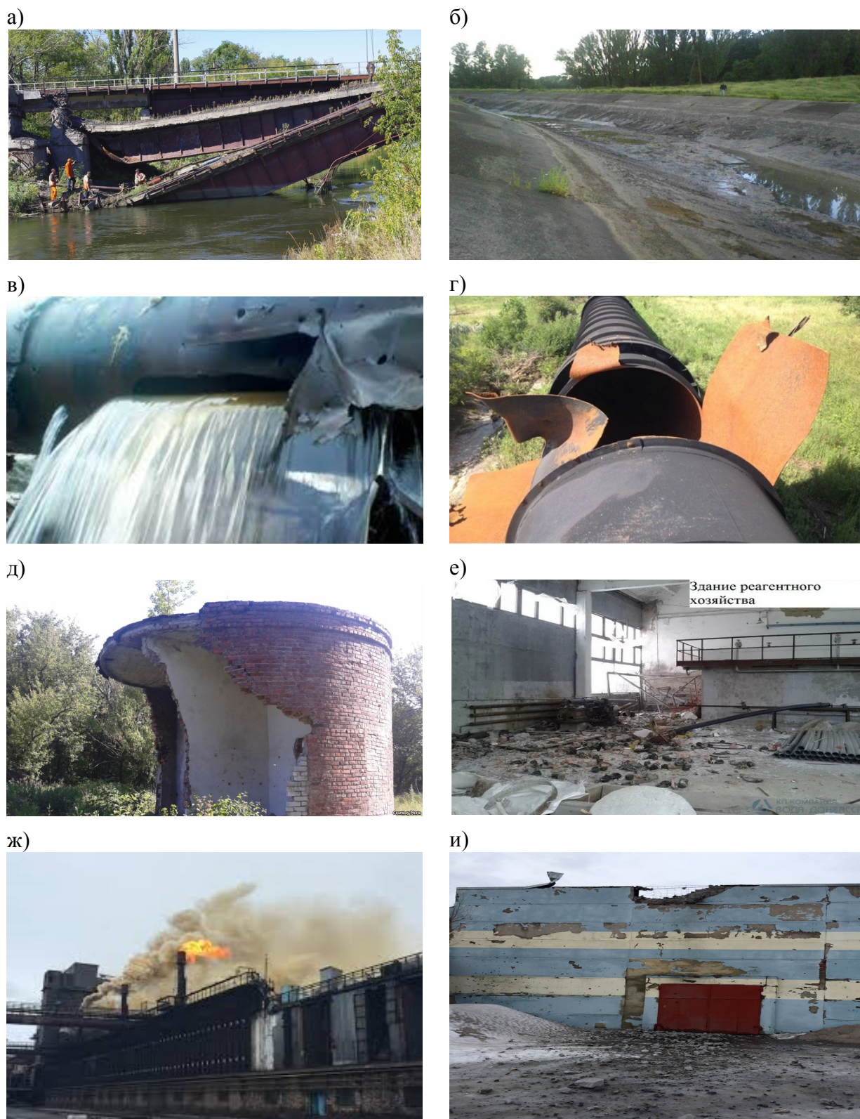
Рисунок 5 Повреждения объектов: а) моста через канал; б) наземной трубопроводной части канала; в) русла канала без воды; г) дюкера; д) КНС в Горловке; е) здания реагентного хозяйства ДФС; ж) эстакады резервного хлоропровода в Авдеевке; и) здания хлораторной ДФС
