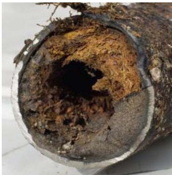
Рисунок 1 Нарост в водопроводной трубе
