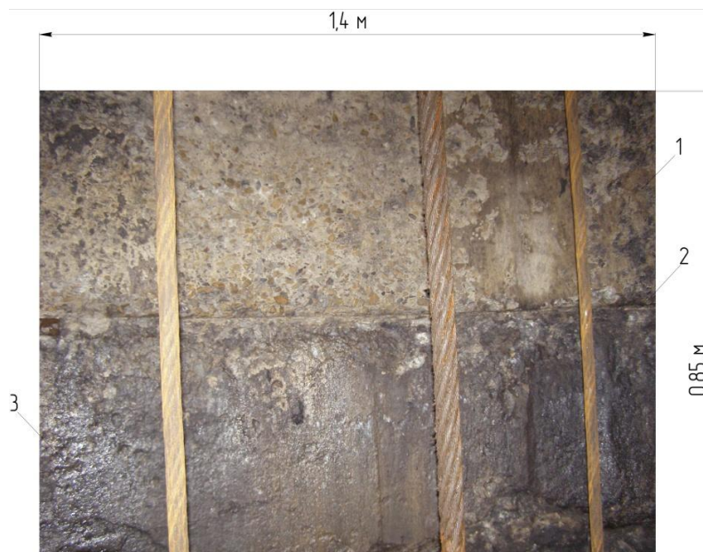
Рисунок 3 – Фотофрагмент состояния бетонной крепи: 1 – бетон; 2 – контактный шов; 3 – следы коррозии бетона
