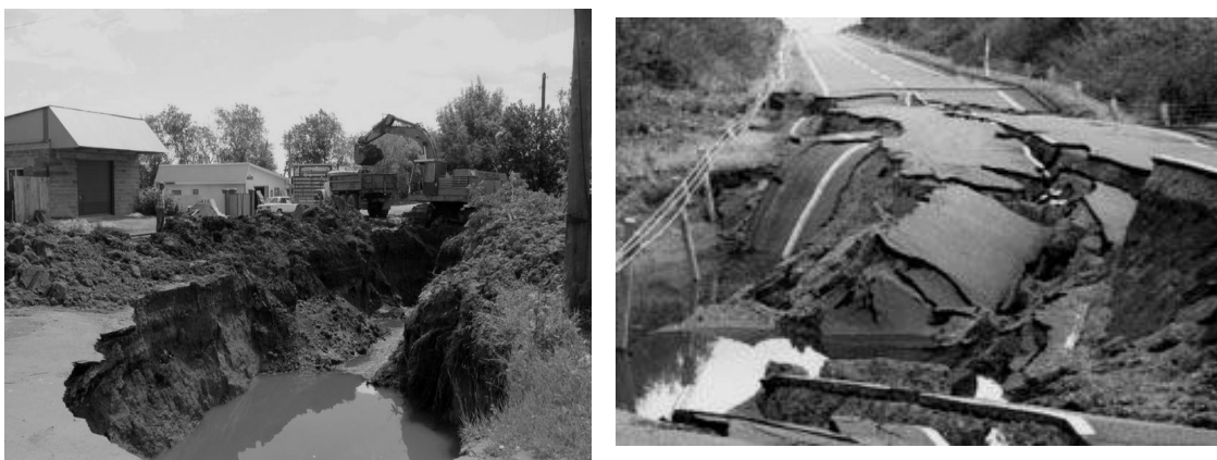
Рисунок 5 - Последствия аварий на канализационных сетях
