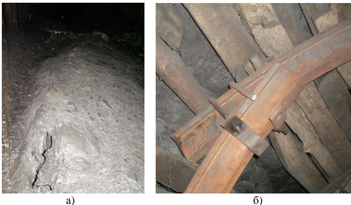
Рисунок 7 – Состояние уклона № 3, сооруженного в выработанном пространстве лав № 3 и № 9 через 3 месяца: а и б – гребень поднятия почвы с ее разломом (лава № 3) и разрыва замкового соединения стойки и верхняка арочной крепи (лава № 9)
