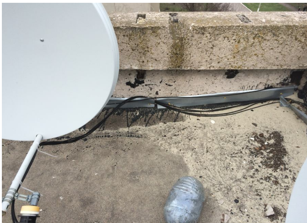
Рисунок 9 — Наличие мусора на крыше
