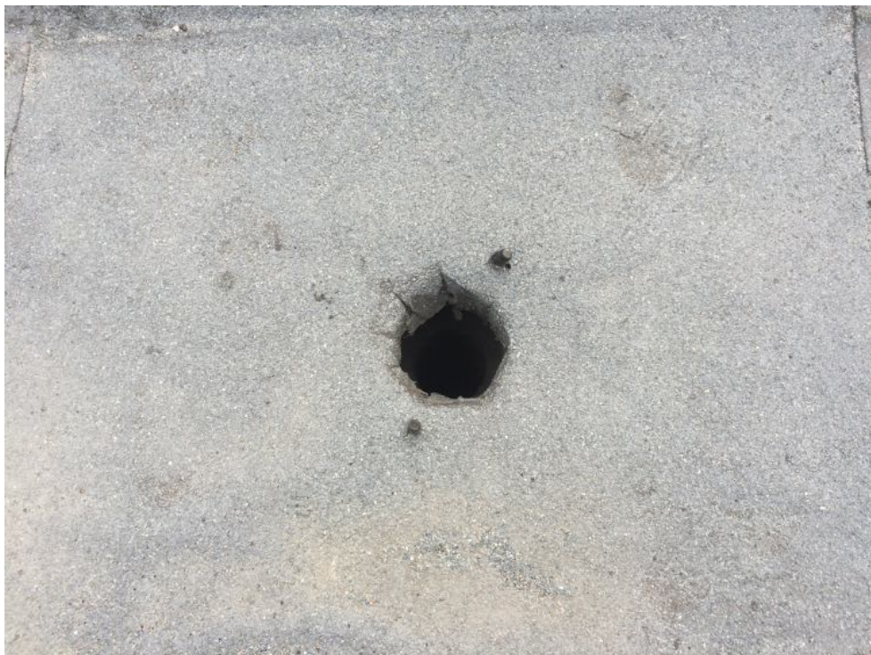
Рисунок 8 — Отсутствие водоприемных воронок
